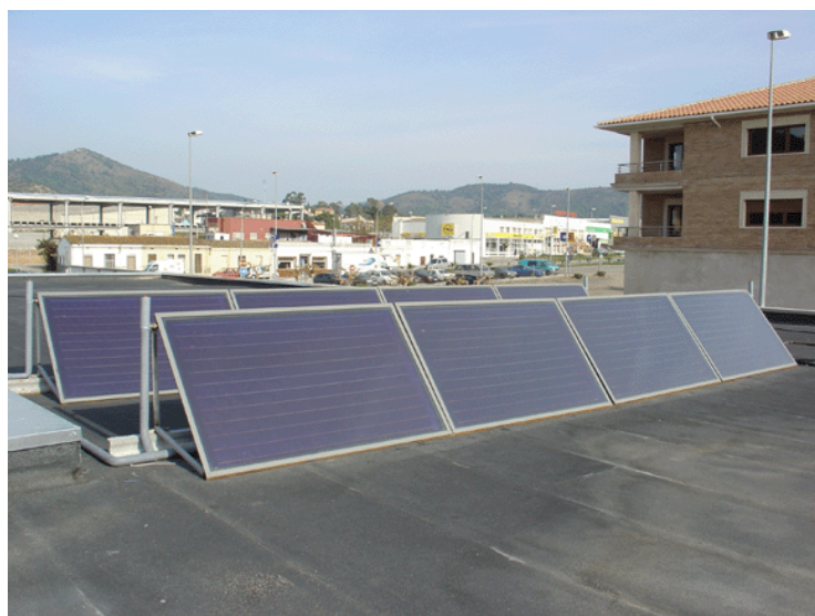
Fotografía 2. Colectores solares instalados en un tejado plano
